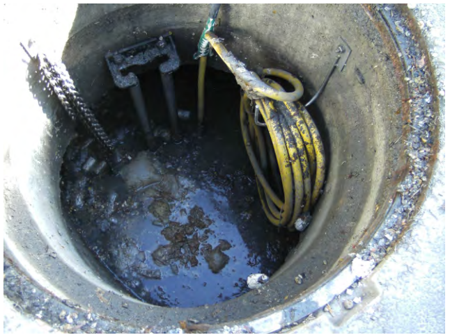
Auf diesem Bild hier können Sie eine verdeckte Pumpstation erkennen, die verstopft und anschließend defekt wurde. Vermeiden wir gemeinsam solche Szenarien und sorgen für eine gute und gesunde Umwelt!
