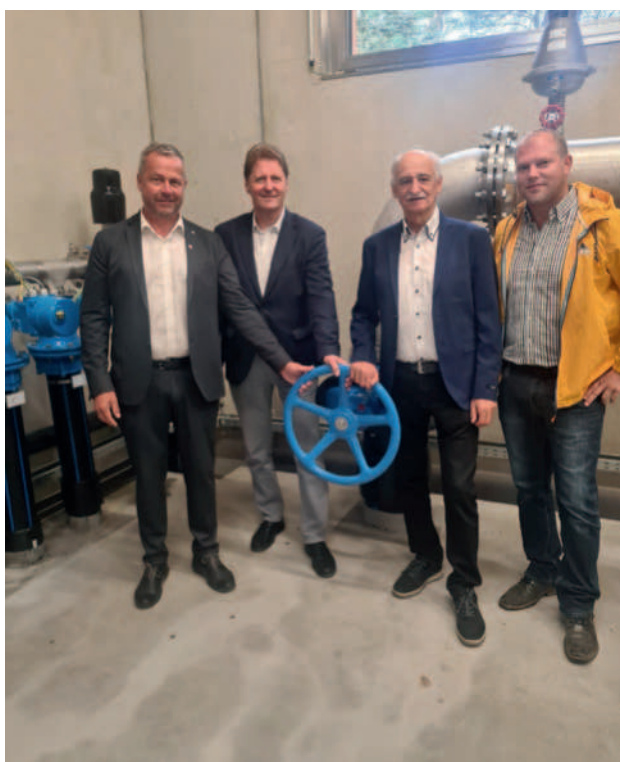
Auch Bürgermeister Robert Tulnik ist beeindruckt von der neuen Anlage, mit der nun auch die Wasserversorgung für das Gemeindegebiet von Fernitz-Mellach nachhaltig gesichert ist
