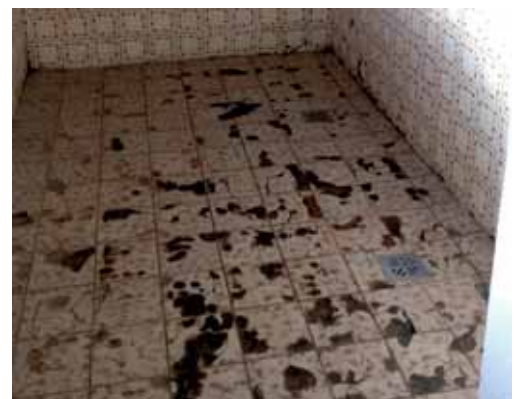
So sehen Fliesen nach mehr als 35 Jahren intensiver Nutzung aus (Verletzungsgefahr usw.).
