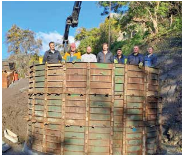
Löschbehälter Zielberg vlg. Bingl
