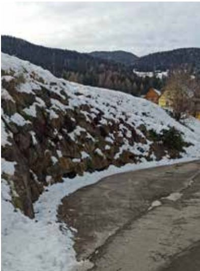
Bevorstehende Sanierung Lutzmannsdorf
