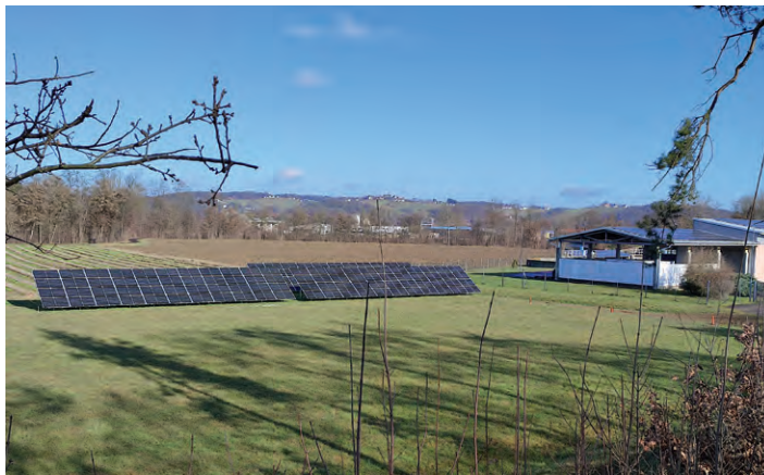
Mit einer Gesamtleistung von 166 kWp kann die PV-Anlage der Kläranlage über 50 % des Stromverbrauchs abdecken.
