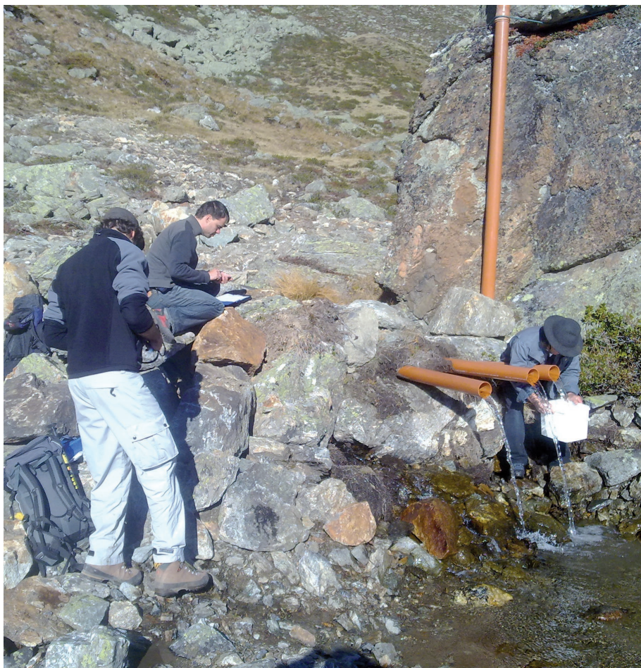
Quellfassungen: im Bild Wassermeister Alfred Thurnes, Planer Alexander Plangger und Techniker Mathias Senn.
