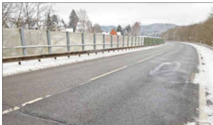
Das Foto zeigt die Schäden im Bereich der Brücke im Wohngebiet „Berggrube“ und die aus Sicht des Rates unterdimensionierte Lärmschutzwand Foto: Volker Gutendorf
