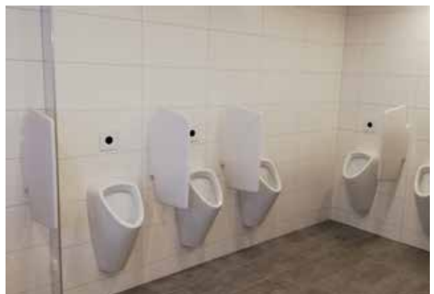
Neue Herren-WC-Anlagen in der Kreischberghalle
