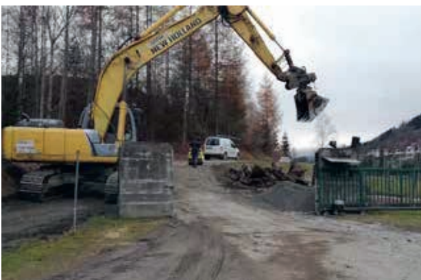
Unwetterschäden am Löwbach
