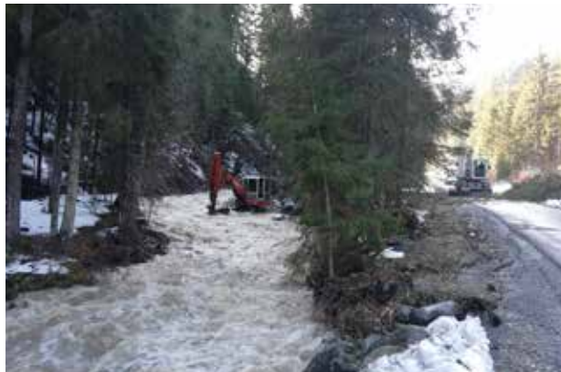
Unwetterschäden an der Grabenstraße/Lorenzerbach
