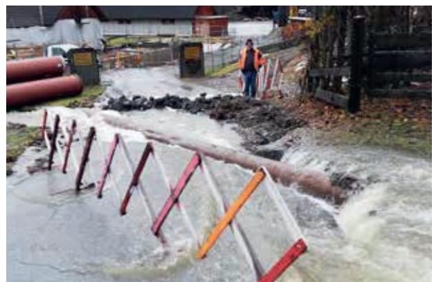
Unwetterschäden am Löwbach
