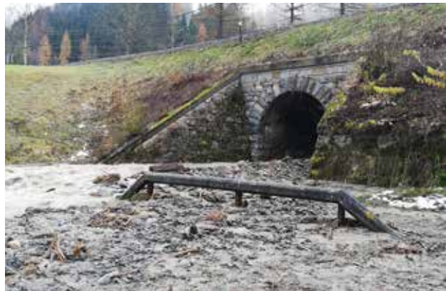
Schwere Unwetterschäden im Bereich Marbach
