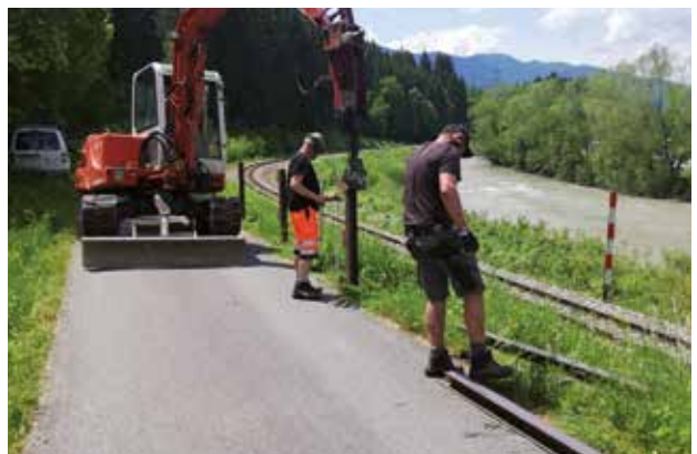
R2 Murradweg Absturzsicherung
