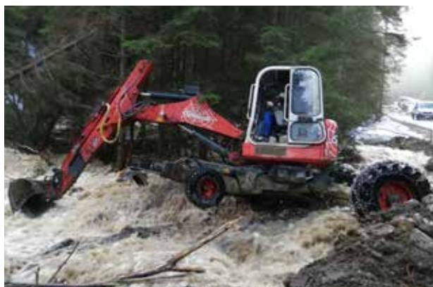
Unwetterschäden an der Grabenstraße/Lorenzerbach
