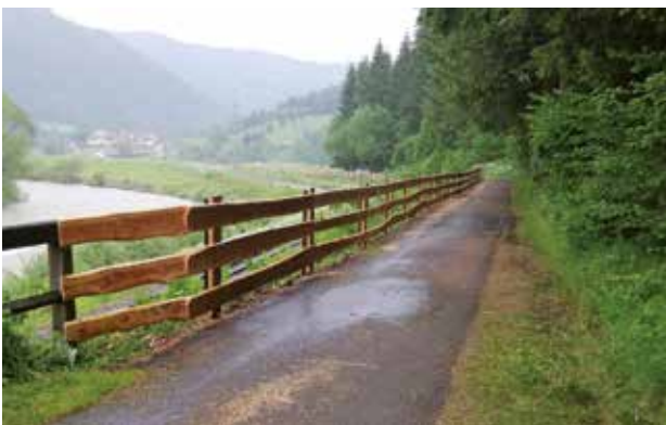
R2 Murradweg Absturzsicherung
