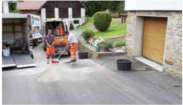
St. Ruprecht Osteinfahrt Schachtdeckelhebung
