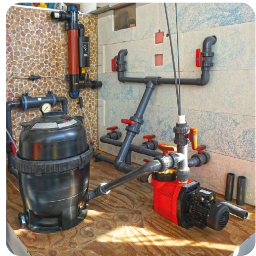
Filter mit Pumpe und Verrohrung
