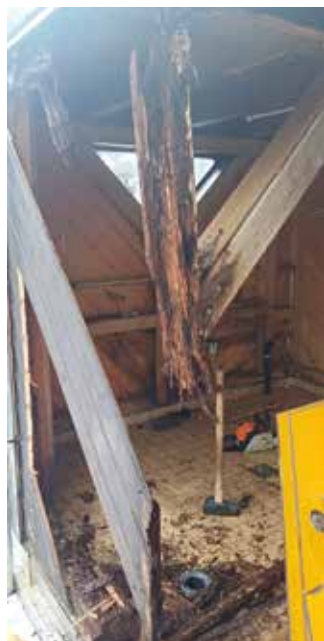
Die Sanierung des Buffets im Alpenbad war offenbar noch dringender als gedacht. Die Holzpfosten waren in keinem guten Zustand mehr.
