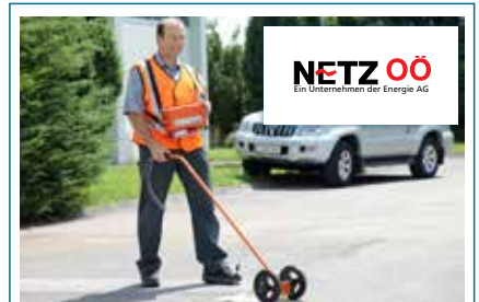
Im Zuge der routinemäßigen Wartung des Gasnetzes wird die Leitungsstrasse mit einem Gasspürgerät abgegangen und auf Funktionstüchtigkeit geprüft.
