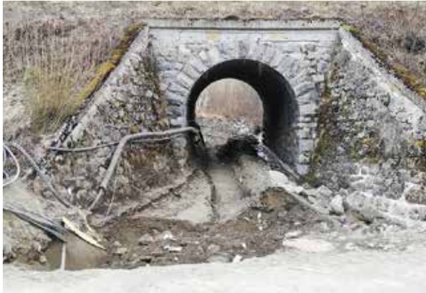
Unwetterschäden Schafferbach vor dem Ausbau
