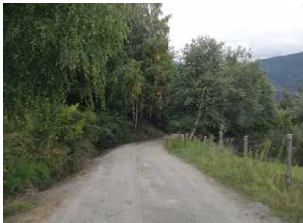
Unwetterschäden Oberes Falkendorf
