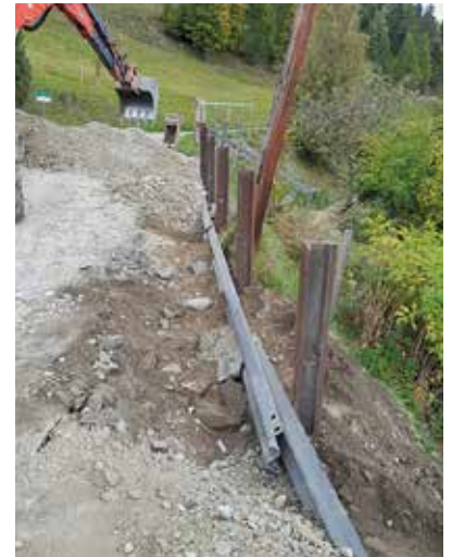
Unwetterschäden Zielbergweg – Rutschung Bereich vlg. Dorfer
