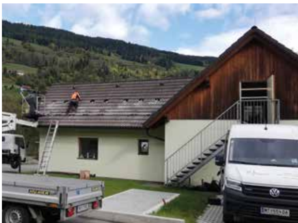
PV-Erweiterung bei der Hauptkläranlage St. Lorenzen PV-Anlage bei der Kläranlage St. Ruprecht-Falkendorf
