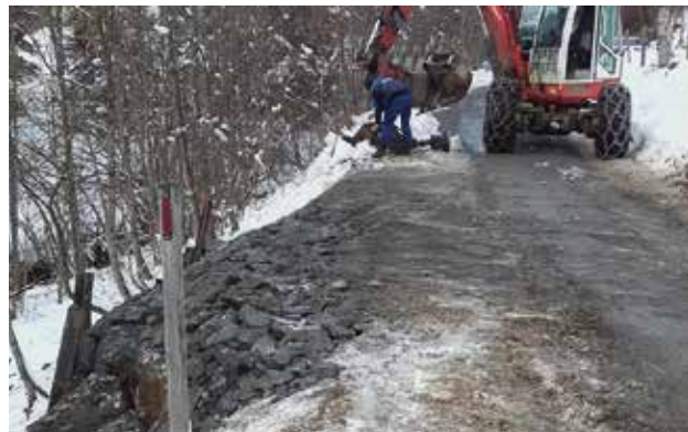
Unwetterschäden Allgauweg – Sanierung der Rutschung
