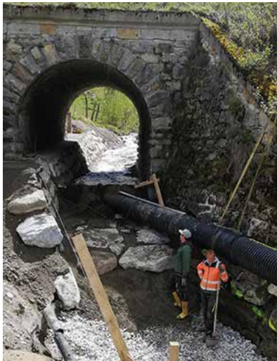
Unwetterschäden Schafferbach – Ausbau im Gange
