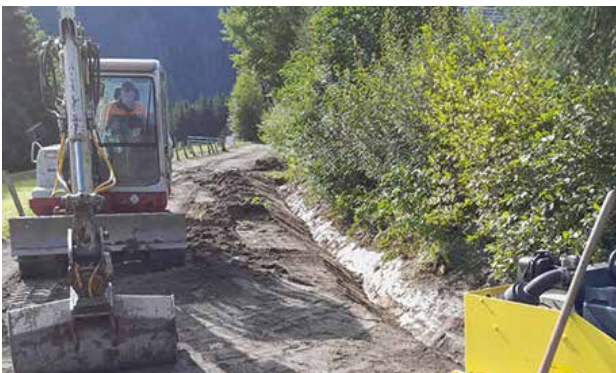
Unwetterschäden – Hinterer Kothschidlergrabenweg
