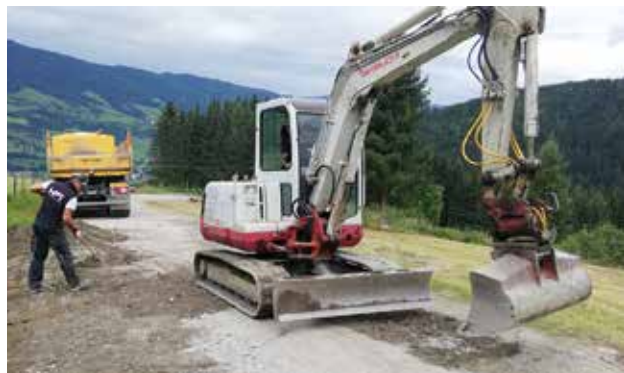
Unwetterschäden – Hinterer Kothschidlergrabenweg
