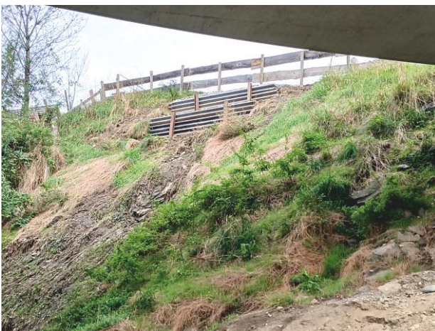
Unwetterschäden im Gemeindegebiet
