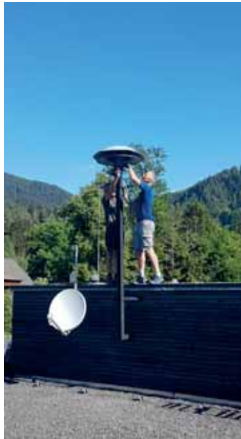
Umbau der Sirene vom „alten Rüsthaus“ auf das Schloß Feistritz.
