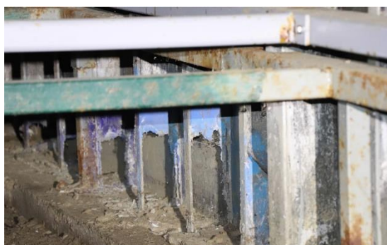
Die Stützen der Beckenwände sind in großen Teilen vollständig korrodiert und bieten keinerlei statische Funktion mehr. Auch die provisorisch eingeschweißten Stützen weisen erhebliche Korrosionsschäden auf.
