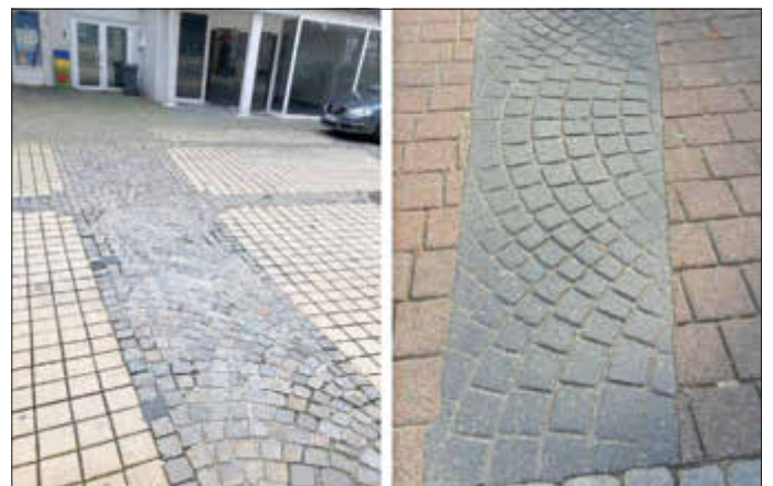
Zur Zeit weisen die Natursteinbänder (links) teilweise erhebliche Schäden auf. Das Band rechts wurde bereits mit Prägeasphalt saniert, das passiert jetzt in der gesamten Fußgängerzone.
