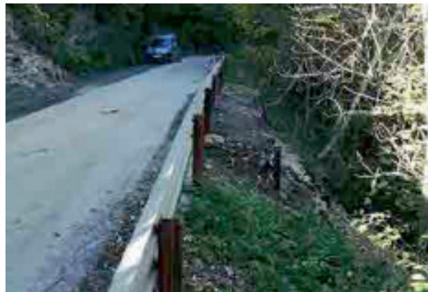
Unwetterschäden beim vlg. Godlerbauer
