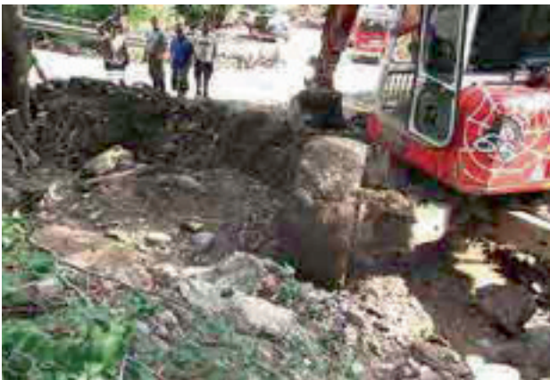
Unwetterschäden beim Dröscherbach
