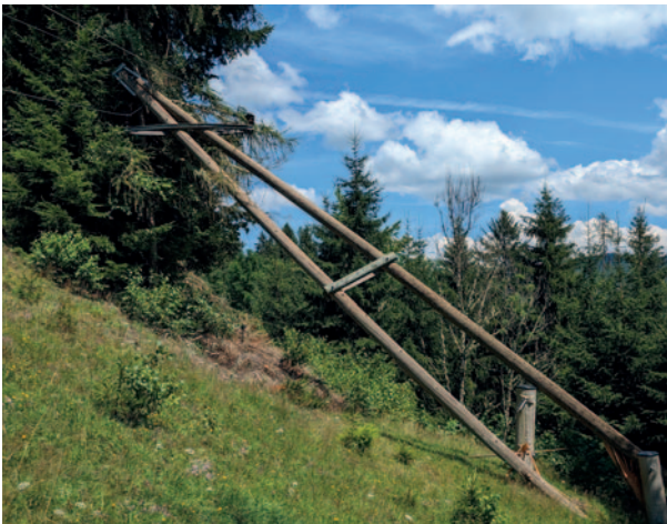
Unwetterschäden im Netzgebiet des E-Werk Kindberg
