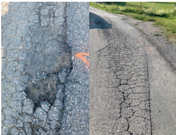
Straßenabschnitte vor Patchmatic
