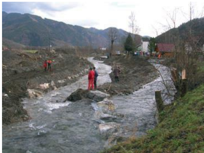
Umlegen der Liesing in ein provisorisches neues Bett während der Baumaßnahme im Bereich Dörf l.
