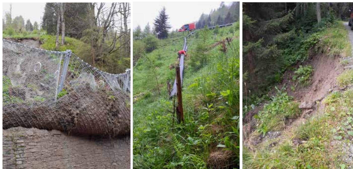
Rutschung im Bereich Grabenwirt und „Regulierung“ bzw. „Verlegung“ des Wassers in diesem Bereich.
