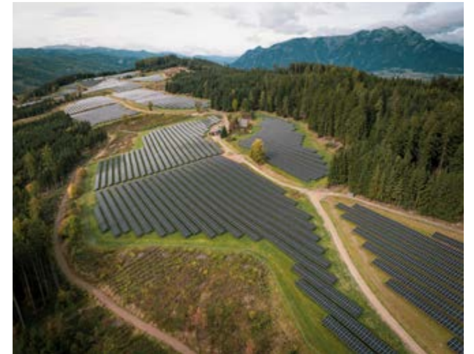
Neue Photovoltaikanlage am Traidersberg aus der Vogelperspektive, Fotokennung: windheimat.com
