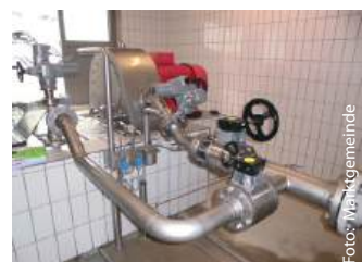
Die Turbine des Trinkwasserkraftwerkes Stainach liefert seit dem Sommer Strom für die Energiegemeinschaft
